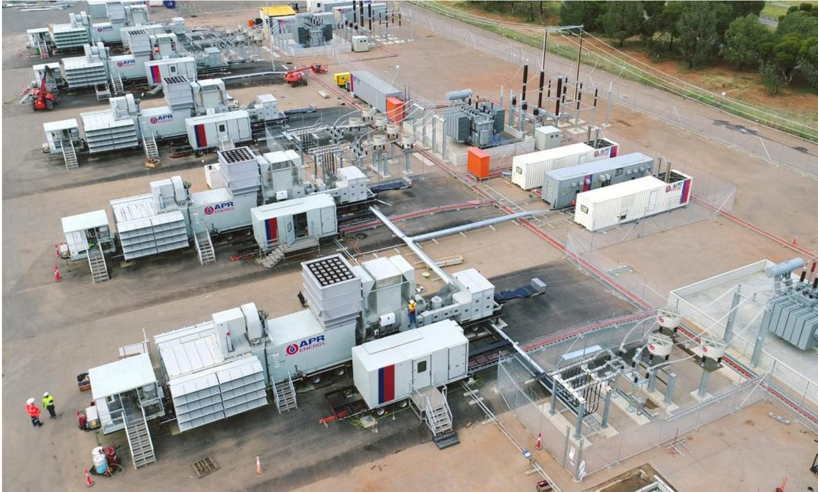
Bild: GE TM2500 mobile gas turbines Quelle: Powermag.com
