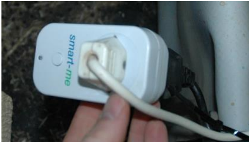
Abb. 9: Strommessgerät Smart-me bei der Stromversorgung der Ferkelnestheizung dazwischengeschaltet
