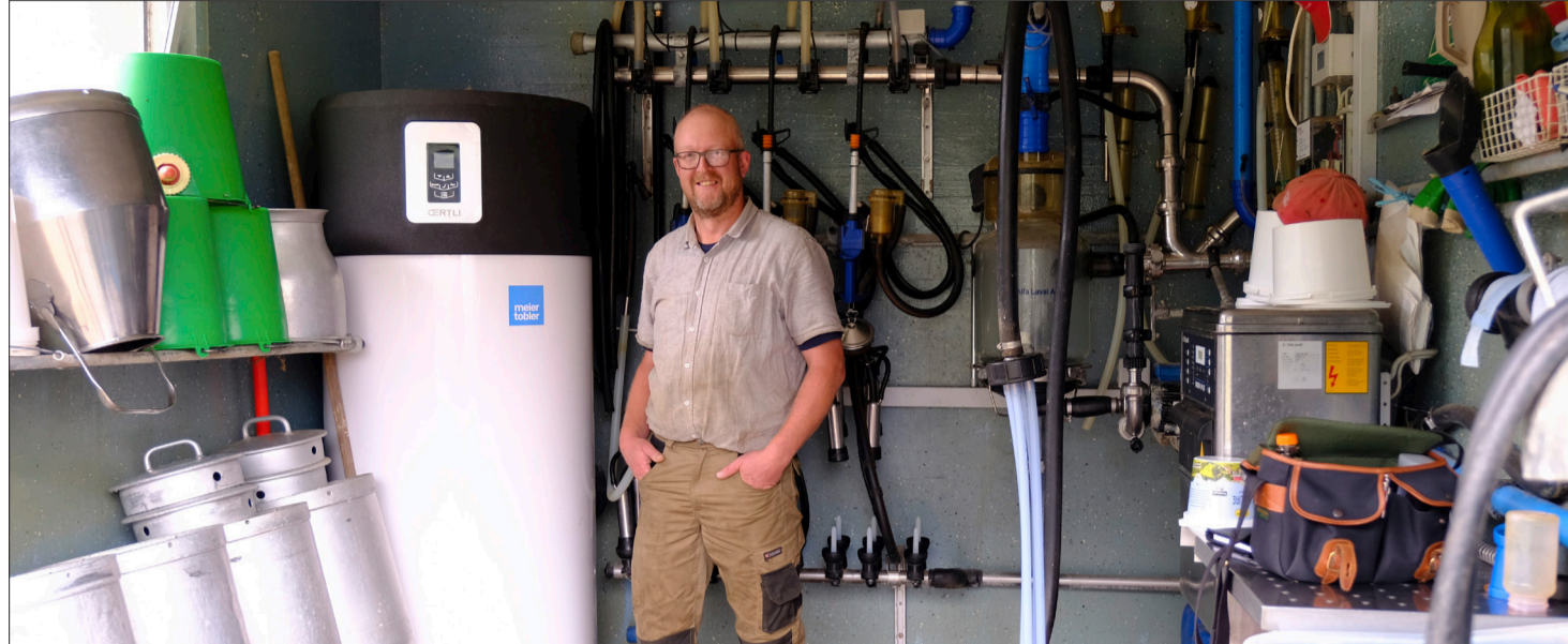
Landwirt René Niederberger hat seinen Wärmepumpenboiler selbst installiert. (Bild: Richard Greuter)
