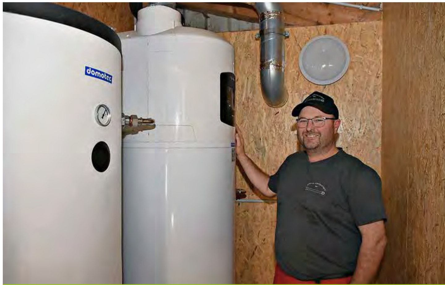
Christophe Barras, avec au premier plan le boiler électrique et au deuxième le boiler PAC.
