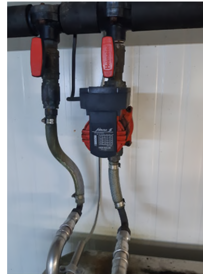
Pumpe Weintank (Kälte-/Wärmeverteilung)
