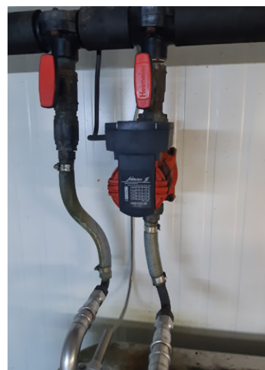
Pompe cuve – distribution de froid/chaleur
