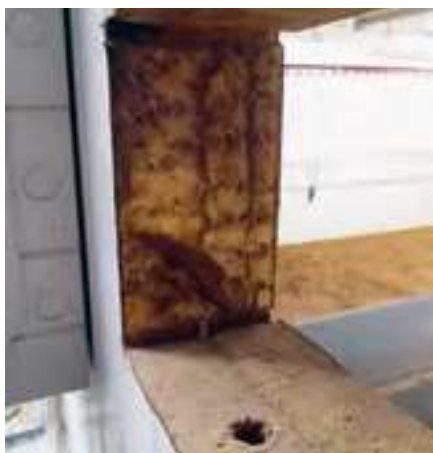
Une isolation performante réduit sensiblement les pertes en chaleur des bâtiments porcins et avicoles. Photos: AgroCleanTech
