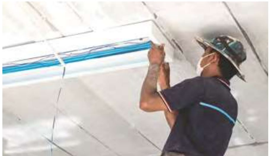
L'utilisation de luminaires «basse consommation» dans les bâtiments de production contribue à limiter la dépense énergétique de la ferme. Photo: phoderstock/Adobe Stock
